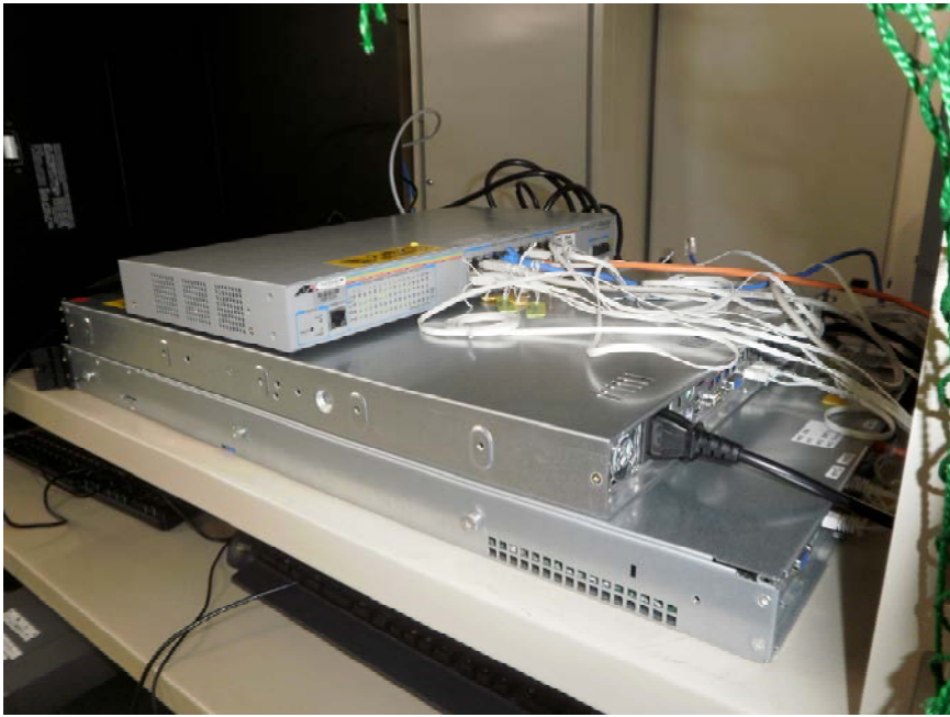
九州大学地震火山センターのサーバ(2台)とハブ
